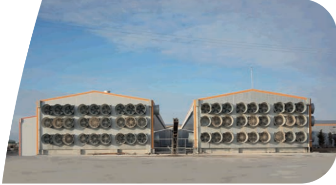
Kümes havalandırma çıkışları
